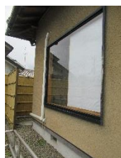
非常口がない。
