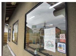
換気できない窓。
